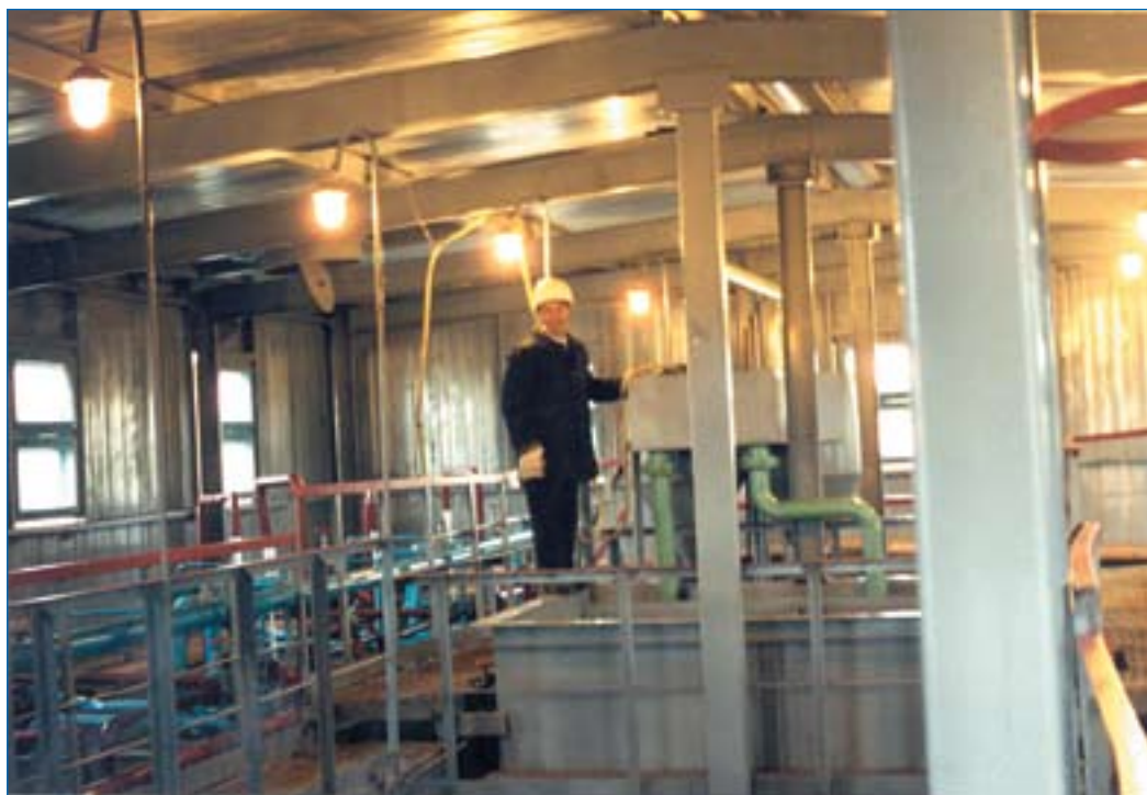
Очистные сооружения КОС-700 в ОАО «Сильвинит», г. Соликамск
